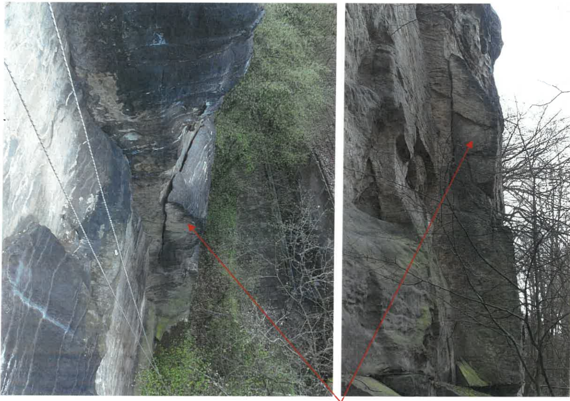
Bilder 17 und 18: auf der Rückseite abgetrennte frei stehende Felsplatte direkt über dem Weg
